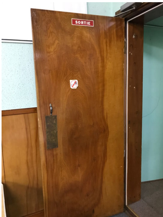
Exemple de porte qui n'ouvre pas dans le sens d'évacuation
