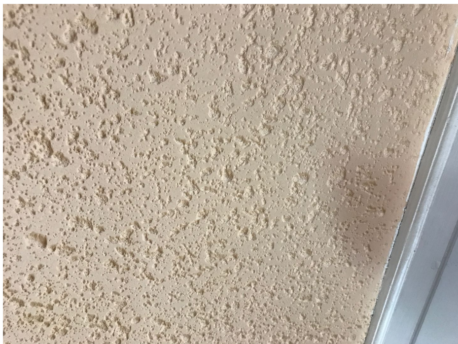
Crépi de ciment des plafonds de la nef et de la sacristie
