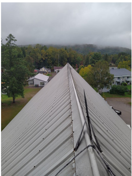
Problème avec le paratonnerre au centre du toit.
