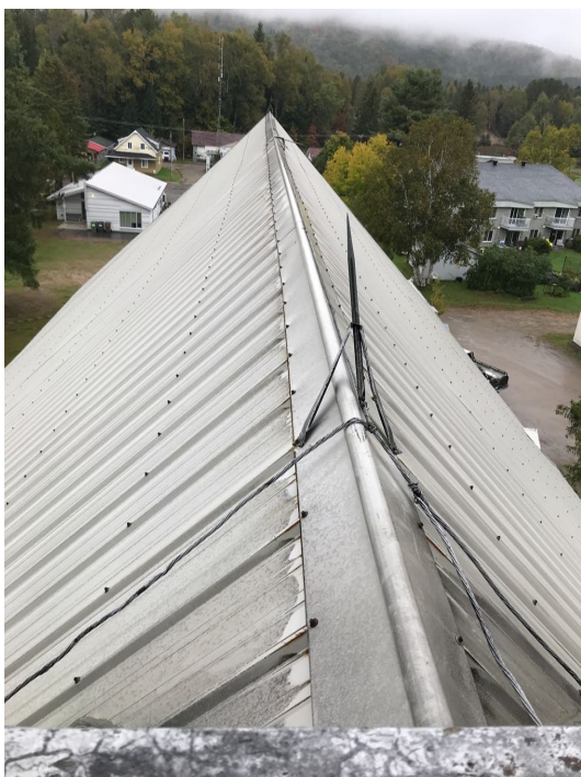
Toiture principale en acier, on observe le système de paratonnerre.
