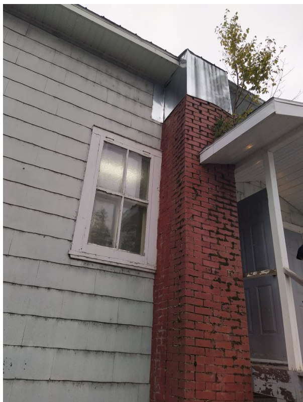
Problème avec la brique de l'ancienne cheminée de la sacristie, à démolir.
