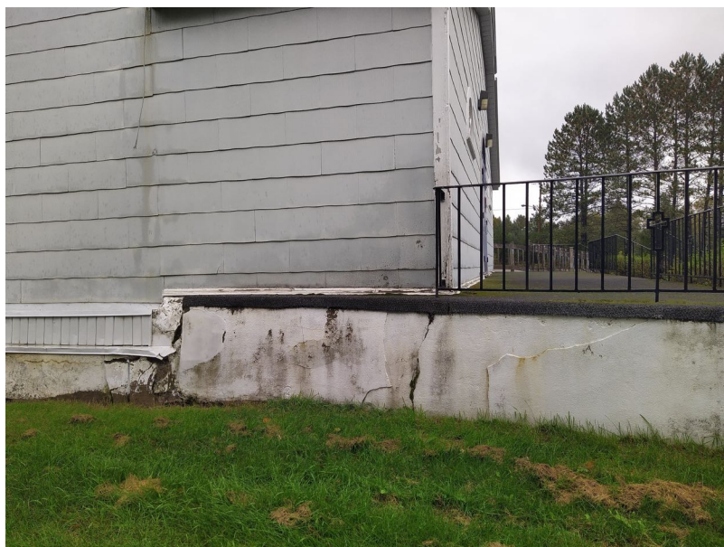
Problème avec le crépi de la fondation à corriger.
