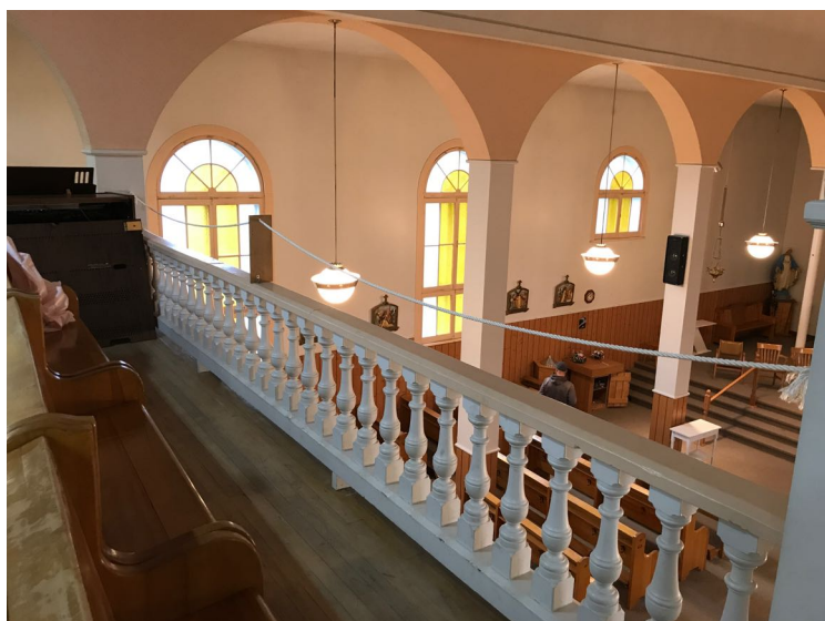
Le garde-corps du jubé est à remplacer.
