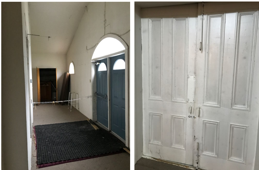
Exemple de portes dont la quincaillerie est à revoir.
